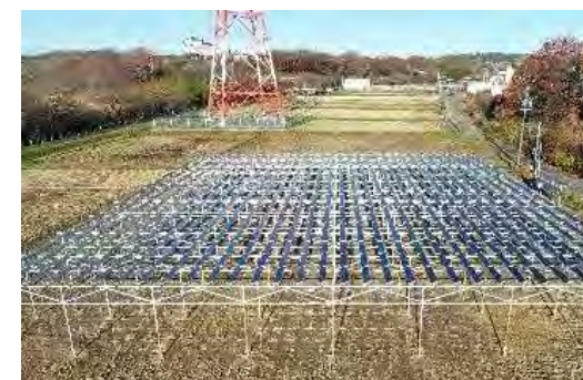
太啓建設(株)浄水SS発電所
