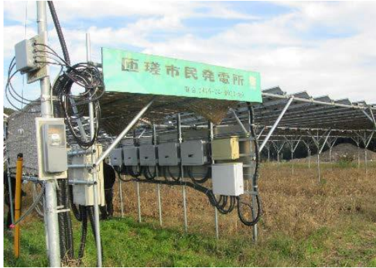
「市民発電所」の看板掲示
