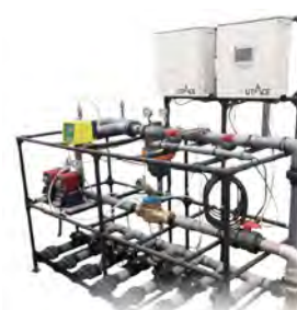
環境制御装置
