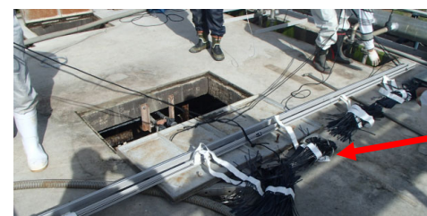
浄化処理施設 (曝気槽)
