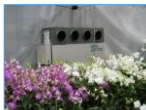
安定的採熱とヒートポンプ利活用
