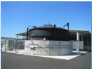
バイオガス発電
