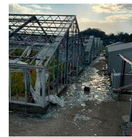
被災したガラスハウス (令和元年房総半島台風)
