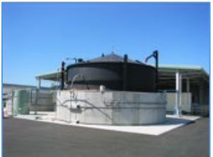
バイオガス発電
