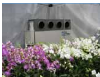
安定的採熱と ヒートポンプ利活用
