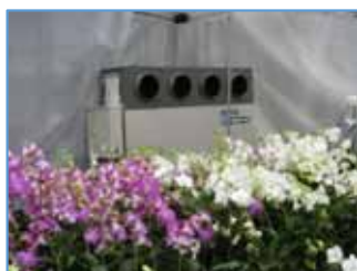
安定的採熱と ヒートポンプ利活用
