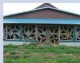
畜舎壁面の換気扇
