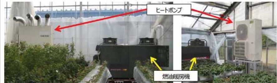
ヒートポンプと燃油暖房機のハイブリッド運転
