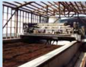
メタンの排出抑制、 良質な堆肥生産に資する 堆肥化処理施設
