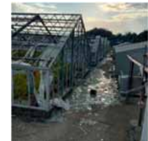
被災したガラスハウス (令和元年房総半島台風)
