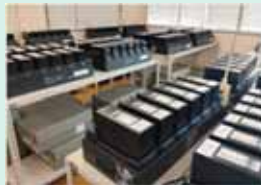
バッテリー保管・充電施設
