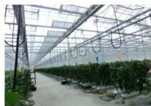
【環境制御システムの導入】
