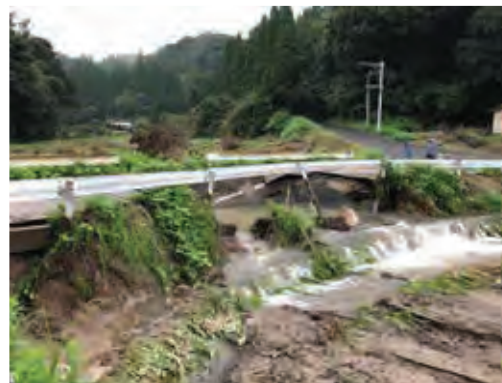
管水路の破裂による営農への影響 （R元.8、鹿児島県鹿屋市）
