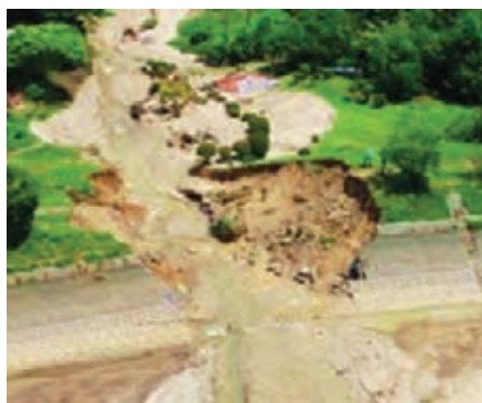
令和4年8月豪雨によるため池の決壊 (洪水吐きの流下能力不足により、 ため池の水が堤体を越流し破堤)
