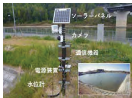
農業用ため池への遠隔監視機器 (水位計等) の設置
