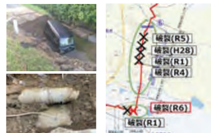
同じパイプラインにおいて連続して破裂が発生
