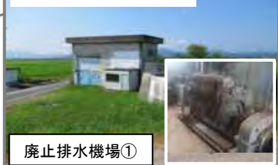
【老朽化が著しい排水機場】
