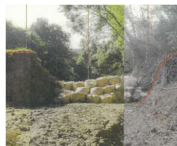
ため池堤体が豪雨で被災
