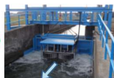
発電施設（設置後）
