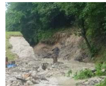
復旧部分が豪雨で再度被災
