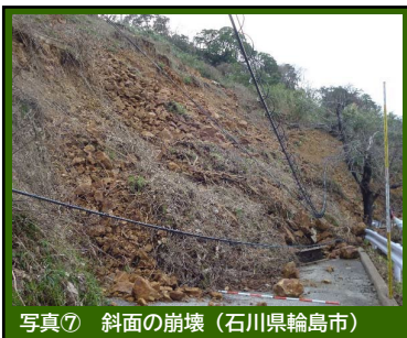
写真⑦ 斜面の崩壊（石川県輪島市）
