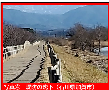
写真④ 堤防の沈下（石川県加賀市）
