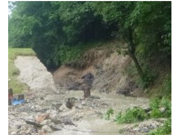
復旧部分が豪雨で再度被災
