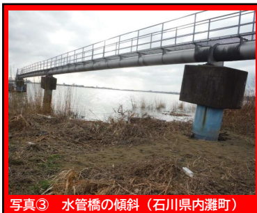
写真③ 水管橋の傾斜（石川県内灘町）
