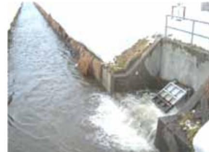
消流雪用水の用水路への注水
