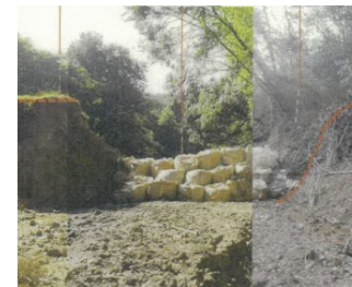
ため池堤体が豪雨で被災
