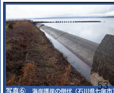
写真⑥ 海岸護岸の倒伏（石川県七尾市）
