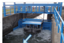
発電施設（設置後）
