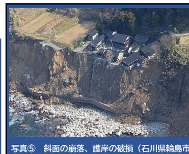
写真⑤ 斜面の崩落、護岸の破損（石川県輪島市）
