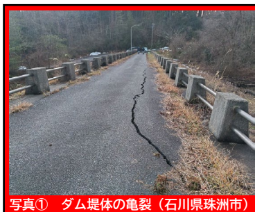
写真① ダム堤体の亀裂（石川県珠洲市）
