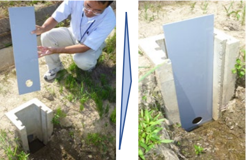
福岡県鯖江市 田んぼダム事業（地域の約8割(1500ha)で実施） （左：調整板設置状況、右：排水樹（調整板挿入））
