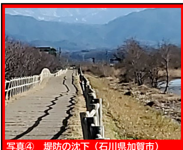
写真④ 堤防の沈下（石川県加賀市）
