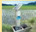
ICTセンサーを活用した深水管理
