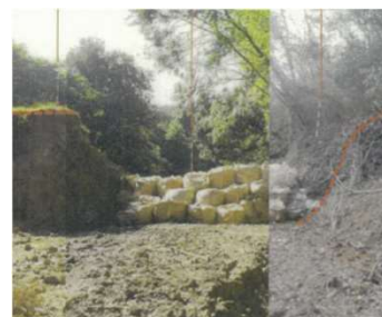
ため池堤体が豪雨で被災
