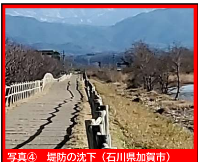
写真④ 堤防の沈下（石川県加賀市）
