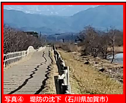
写真④ 堤防の沈下（石川県加賀市）
