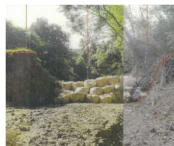
ため池堤体が豪雨で被災
