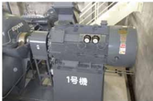
高効率電動機への更新による 省エネルギー化
