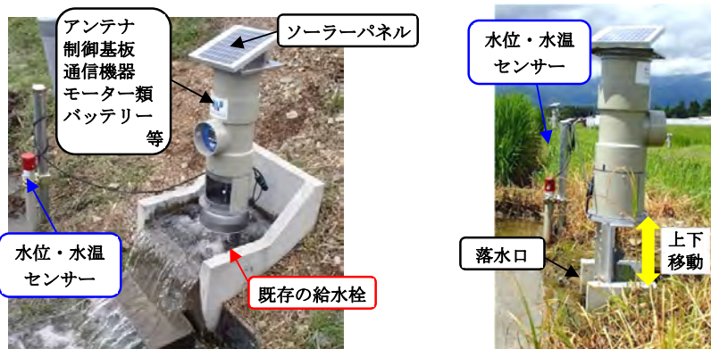
図-4.10.3 給水栓（左）及び落水口（右）に取り付けたほ場水管理システムの制御装置
