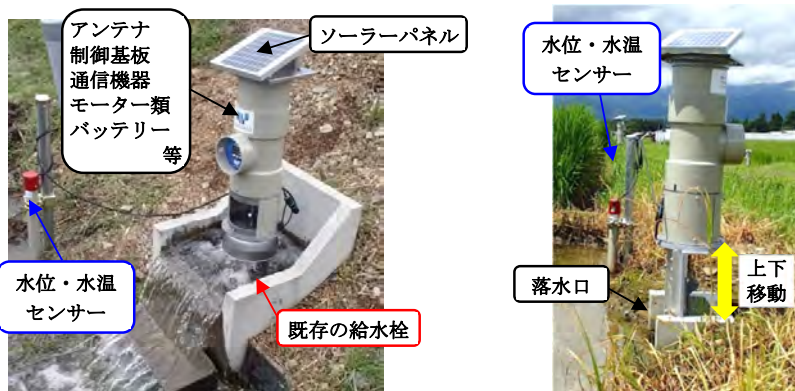
図-3.10.3 給水栓（左）及び落水口（右）に取り付けたほ場水管理システムの制御装置
