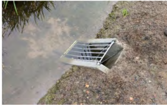
写真-4.7.2 スクリーン付き落水口 8)
