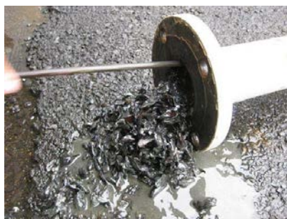
配管の目詰まり
