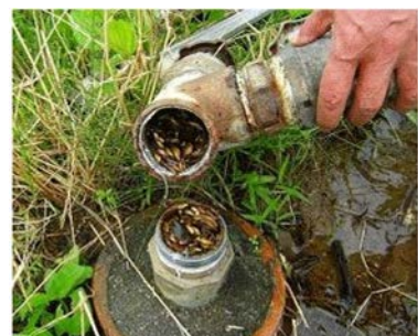
給水栓の目詰まり
