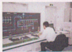
水管理システム導入による管理の一元化
