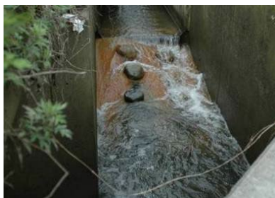
改良された魚道（片斜面粗石付魚道）
