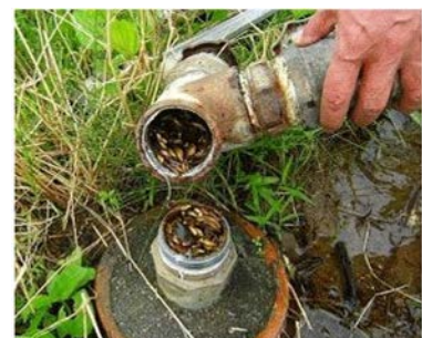
給水栓の目詰まり
