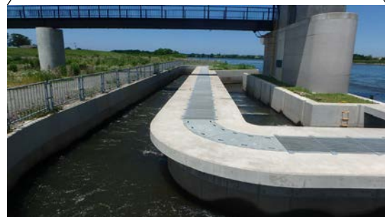
整備後の左岸魚道 （粗石付き斜路型魚道、階段式魚道）
