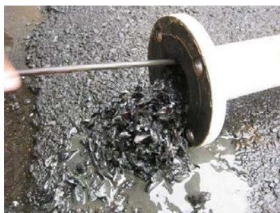
配管の目詰まり
