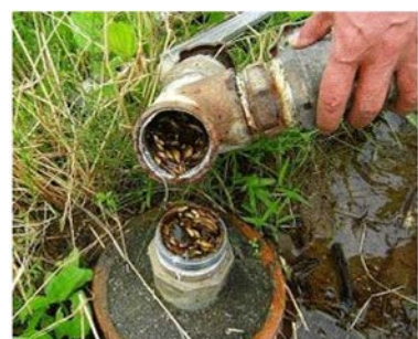
給水栓の目詰まり
