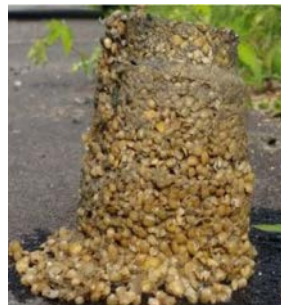
ストレーナーの詰まり
