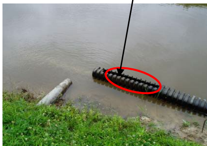
電線管の排水路側末端を水面に浮かせている
