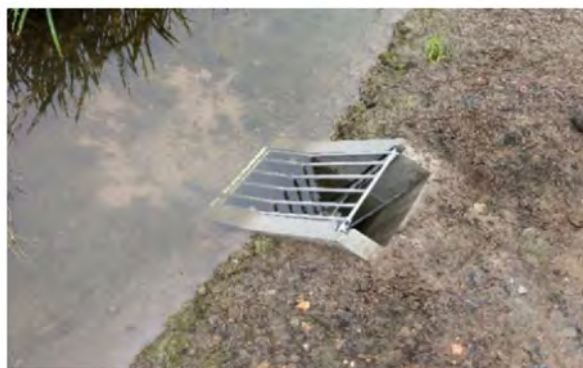
写真-4.7.1 スクリーン付き落水口 8)
