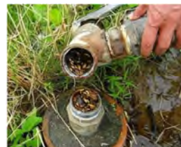
給水栓の目詰まり
