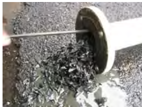
配管の目詰まり
