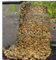
ストレーナーの詰まり
