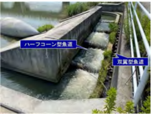
伏樋堰に設置された魚道
