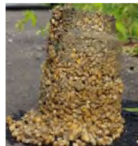
ストレーナーの詰まり
