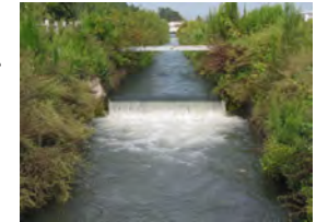
現況の状況 (落差工により、魚類等の移動経路が分断されていた。)
