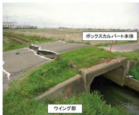
図-10.2.9 地震によりカルバート区間で発生した段差 24)
