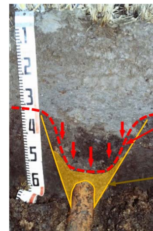
疎水材(モミガラ)の腐食状況
