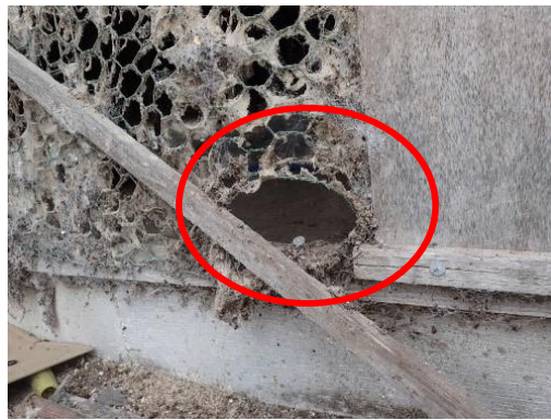
金網や防鳥ネット等の 破損
