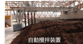
自動攪拌装置
