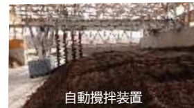
自動攪拌装置
