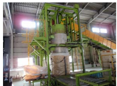
圧縮梱包機2基
