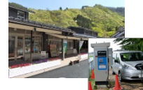
EV車等への給電設備
