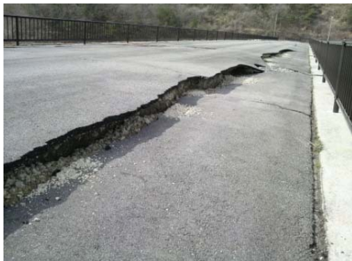
被害状況 [ダム天端に亀裂及び沈下が発生] (平成23年3月)
