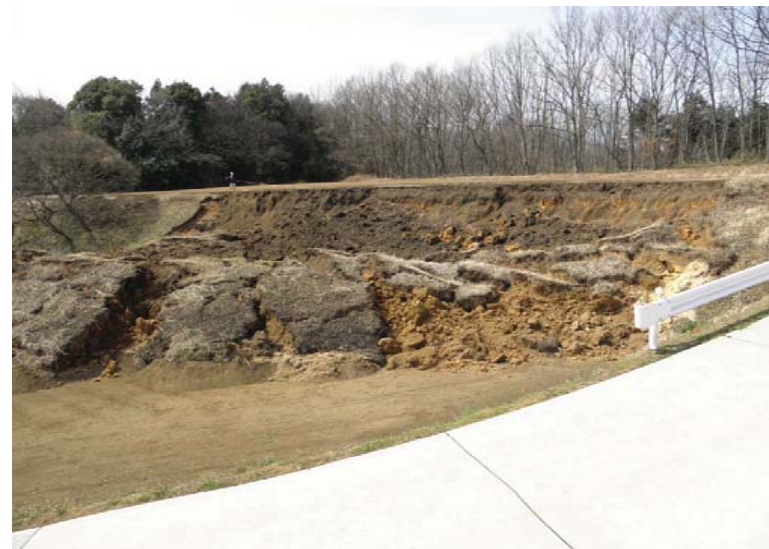
被災状況 [法面が崩壊し、農地に土砂が流入] (平成23年3月)
