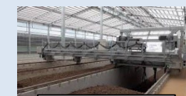
0-列-式発酵設備
