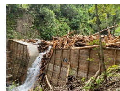
治山ダムが土砂・流木を捕捉し、 下流域への被害を防止
