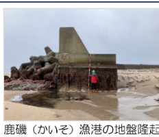
鹿磯（かいそ）漁港の地盤隆起
