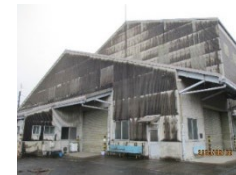
老朽化した施設
