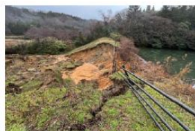
ため池の被害
